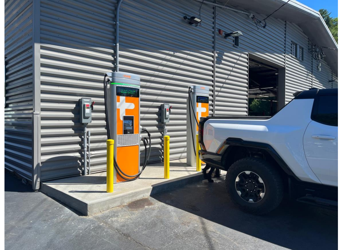
DCFC at an EEN EV Dealership
