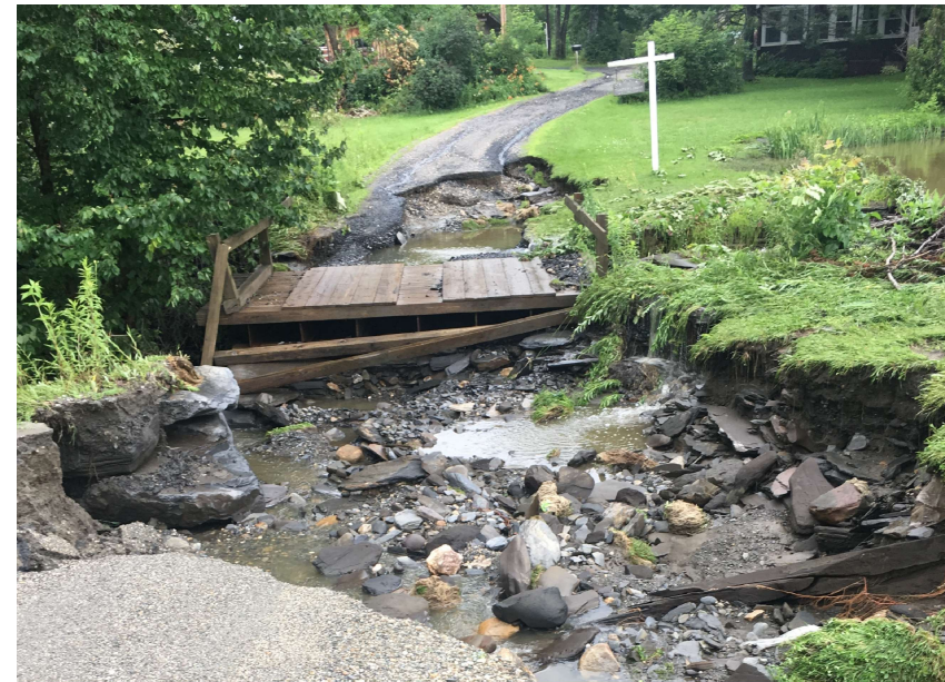
Vatters Dam, Northfield, SIGN Hazard
