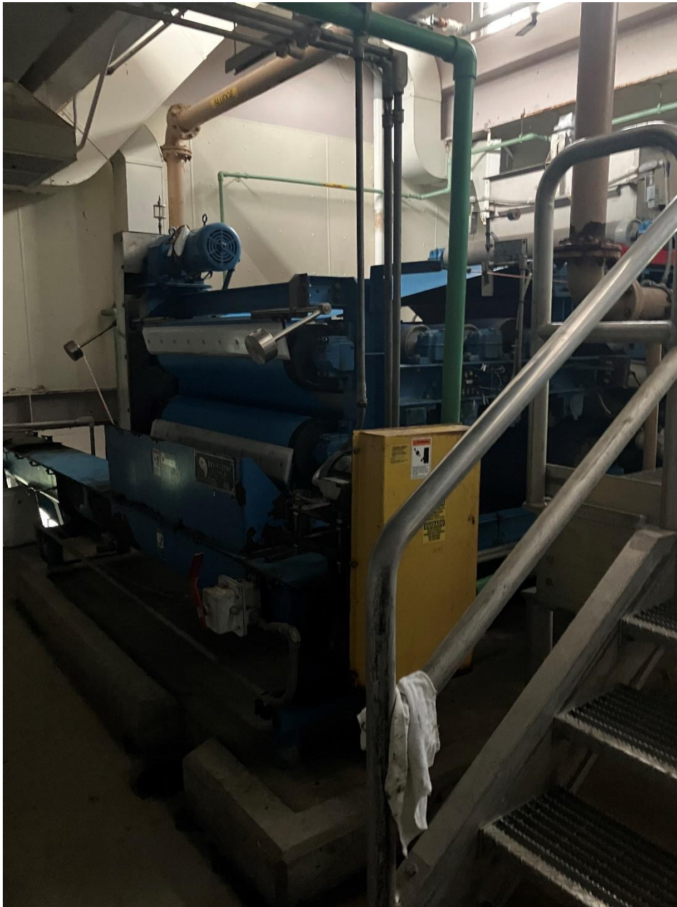
15- Sludge Filter Press
