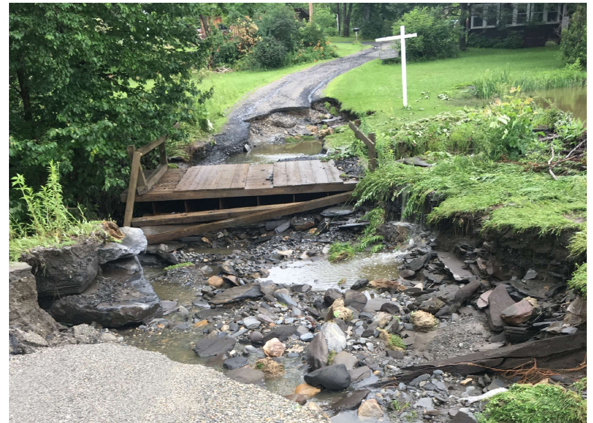
Vatters Pond Dam, Northfield, SIGN Hazard
