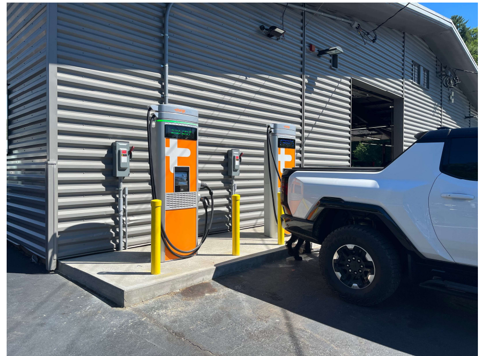
DCFC at an EEN EV Dealership
